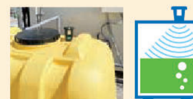
検知センサー取付タンク
